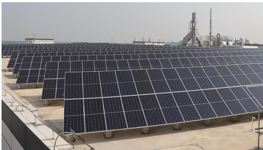
深科技合肥工厂光伏发电
